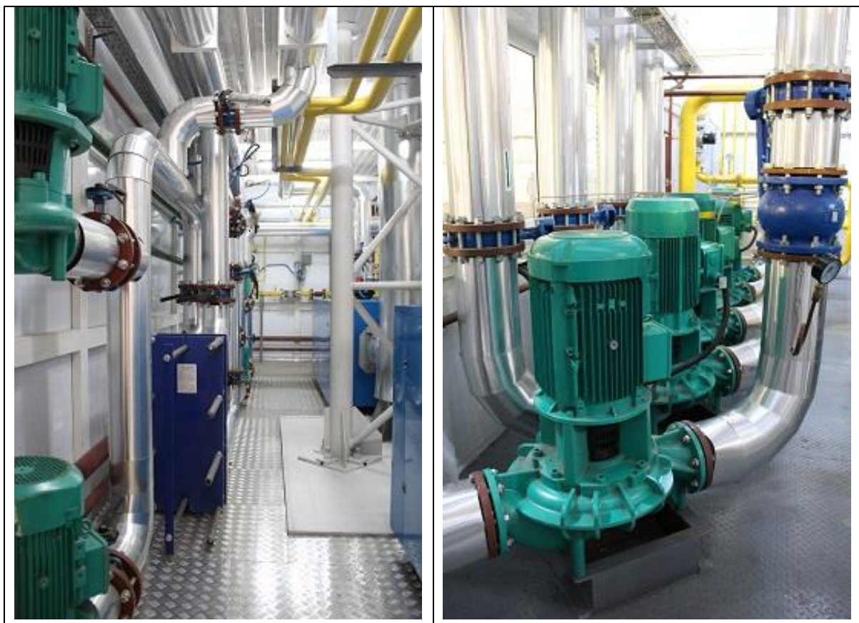
Рисунок 4.1.2. Котельный зал и насосная группа.
