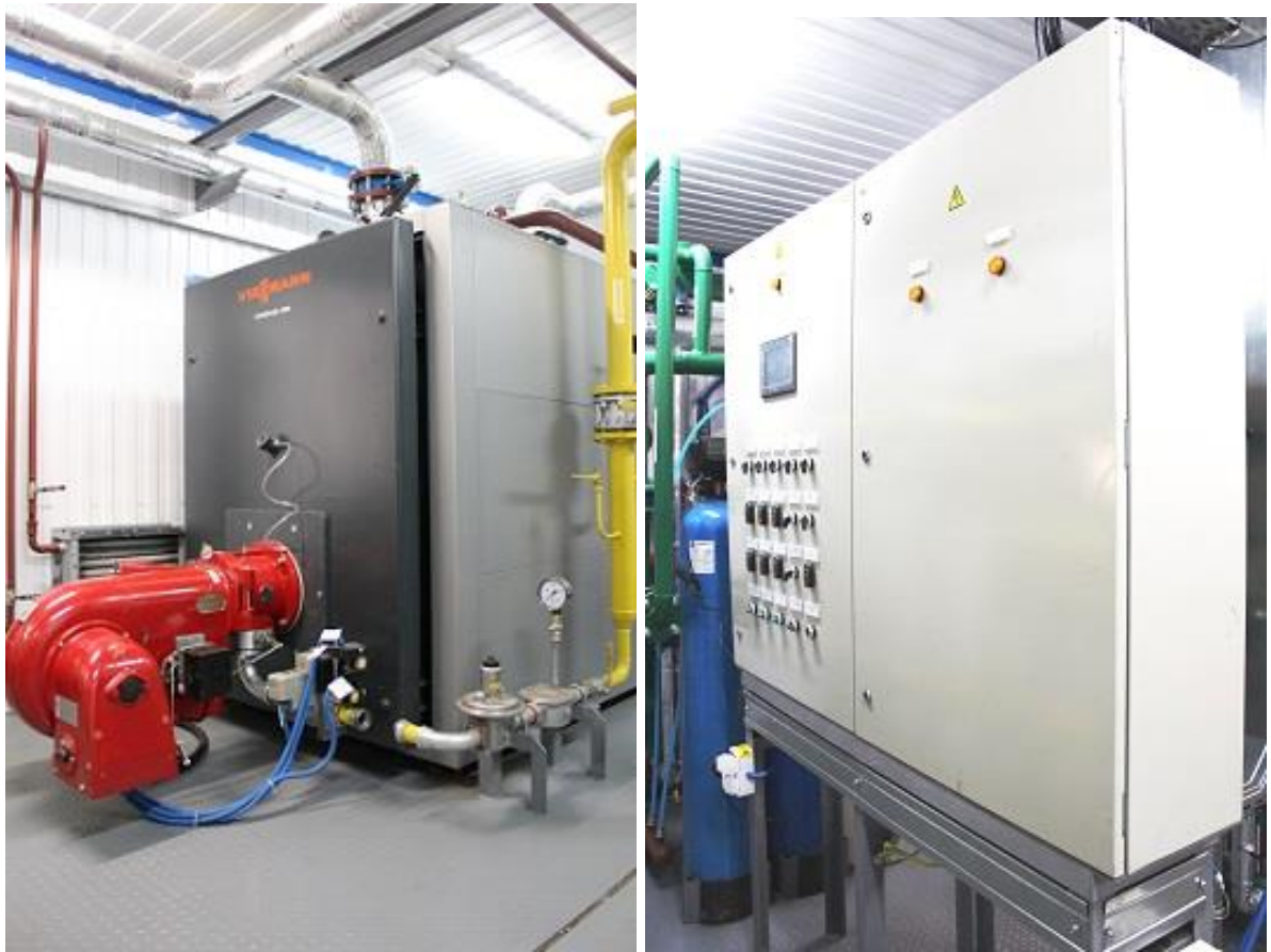
Рисунок 4.1.3. Водогрейный котел Viessman и шкаф управления.
